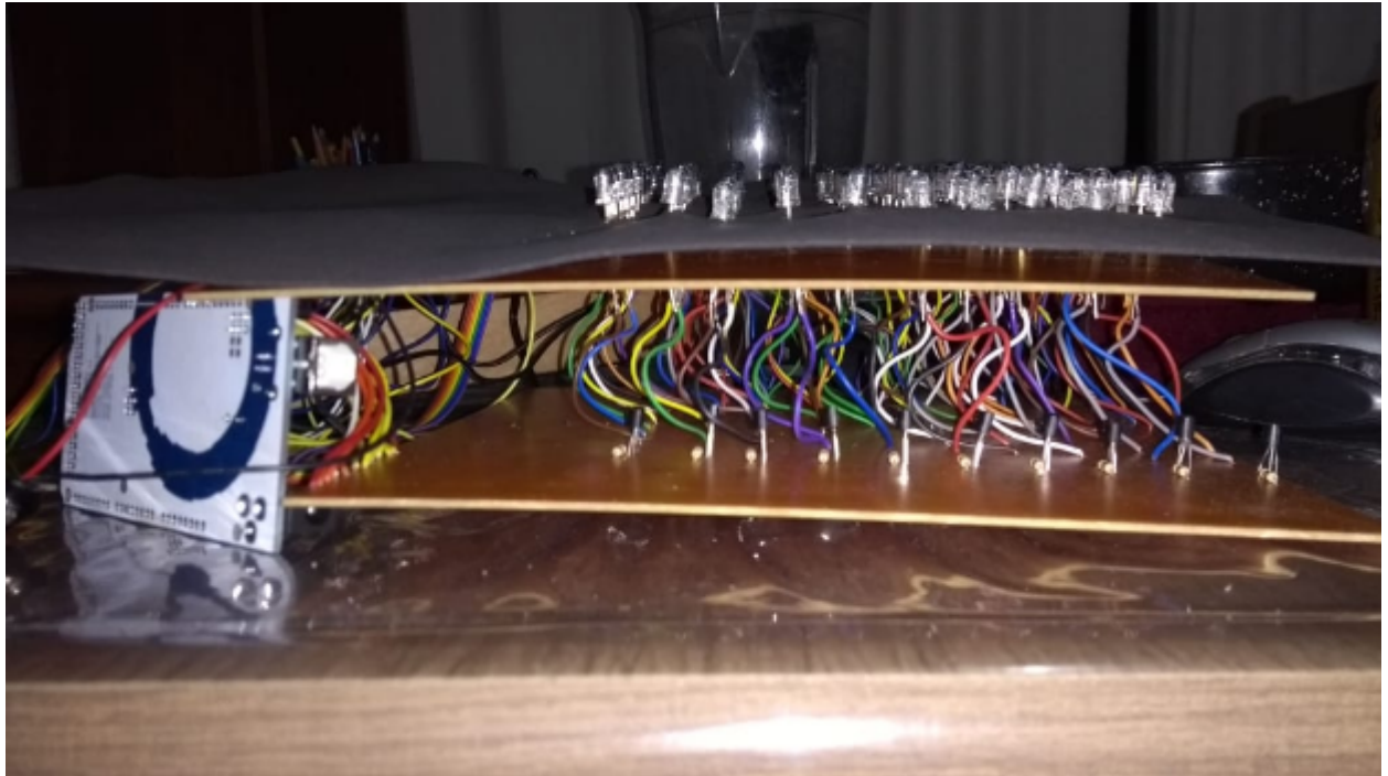
Figura 10: Fios dos circuitos do painel
